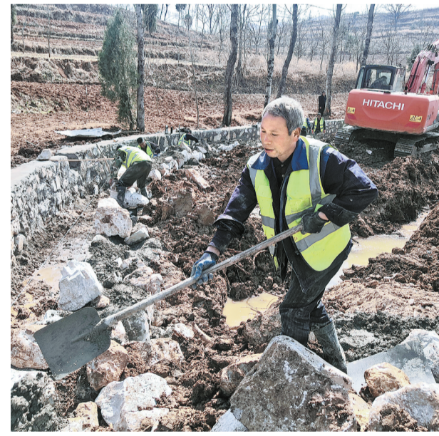
3月10日,工人正在洛南县景村镇脱岭村修建长540米的排洪渠。据悉,这一工程属于高标准农田建设项目,是继修建生产道路、治理滑坡体之后,又一保护农田的工程举措,工程预计月底完工。(记者 肖云 摄)
