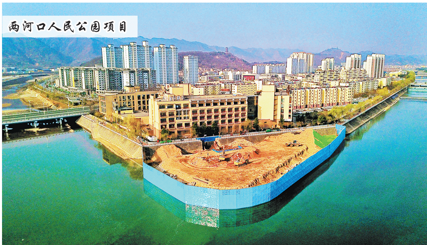
位于中心城区丹江河与南秦河交汇处的西南侧的两河口人民公园项目,将水生态保护、城市微休闲板块和游憩活动有机结合,设计建设沙滩1980平方米、环岛步道500米、栏杆337米以及张拉膜遮阳伞、绿植等。图为3月13日记者航拍的两河口人民公园基础建设施工现场。
