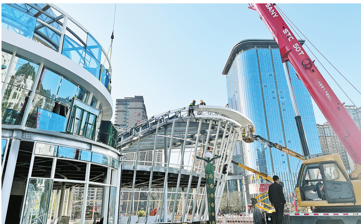
4月2日，山阳县沁水公园水上设施项目正在紧锣密鼓施工。该项目是山阳县深入推进“两拆一提升”，打造集城市文化品位、休闲娱乐、水环境治理为一体的重点项目，建成后对提升城市品位、丰富群众生活具有重要意义。（本报记者 李敏 摄）
