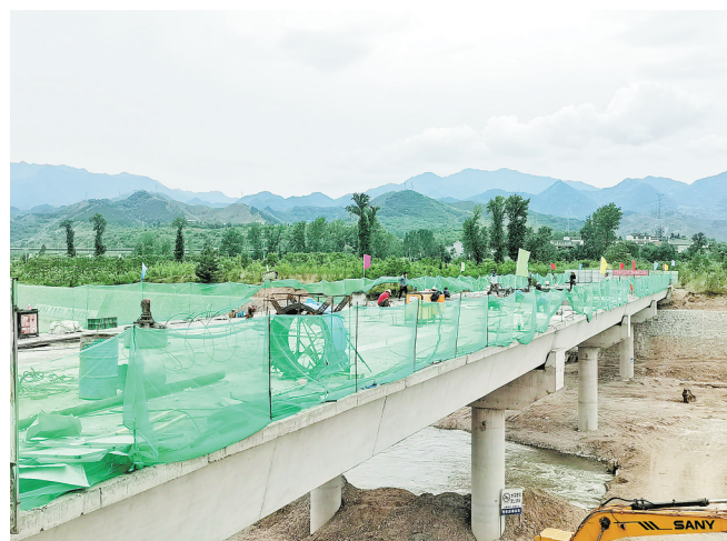
5月17日,施工人员在商州区现代工业产业园金湾大桥工程施工。据了解,金湾大桥建设工程位于夜村镇唐塘村北侧,建成后横跨丹江河连接两岸。目前,该工程主体已经基本完工,预计7月底建成。(本报记者 王孝竹 摄)
