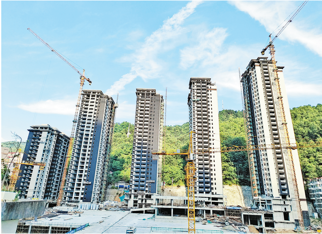
近年来,柞水县聚焦惠民生、补短板,坚持以“完善城市功能、改善人居环境、提升城市品位”为重点,全力加快实施县城中心片区棚户区改造民生工程。图为5月25日,该工程封顶已完成,正在进行外墙面施工。(本报通讯员 余偏林 摄)
