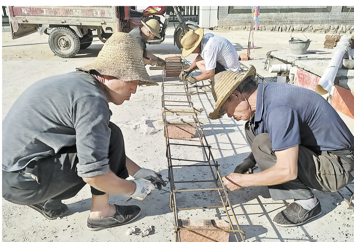
7月21日,施工人员在丹凤县蔡川镇留仙坪村红色美丽村庄项目新建大桥上绑扎大桥护栏龙骨。目前,该大桥已完成桥梁吊装,正在进行大桥配套护栏和景观建设。大桥投入使用后,可解决留仙坪村群众出行困难,方便游客参观红色教育基地。(本报记者 贾书章 摄)
