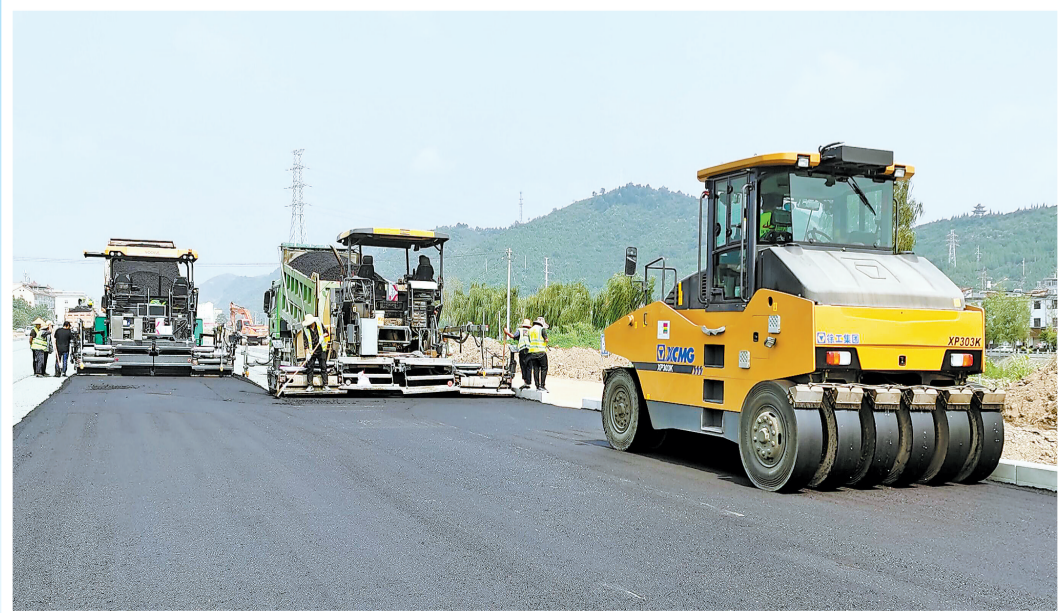
8月4日，市区环城南路主线正在进行沥青摊铺施工作业。据了解，该项目预计9月底完工。（本报通讯员 杜妍 摄）
