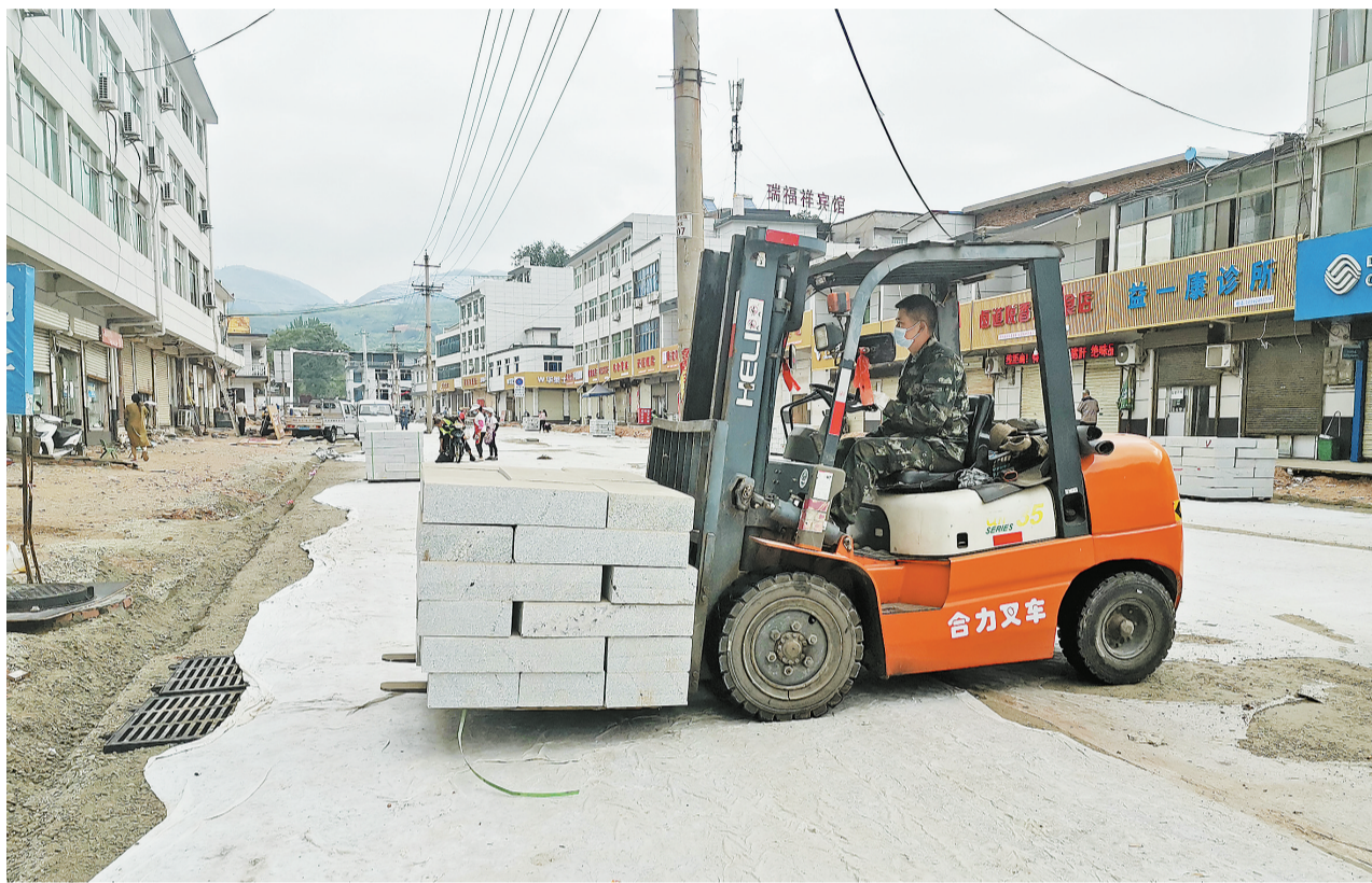
9月11日,商州区沙河子镇农贸街提升改造工程现场,工人操作叉车搬运路沿石石材。农贸街的改造提升将会实现街拓宽、门店整齐、管网齐全、环境优美、经营规范的新景象。(本报记者 王孝竹 摄)
