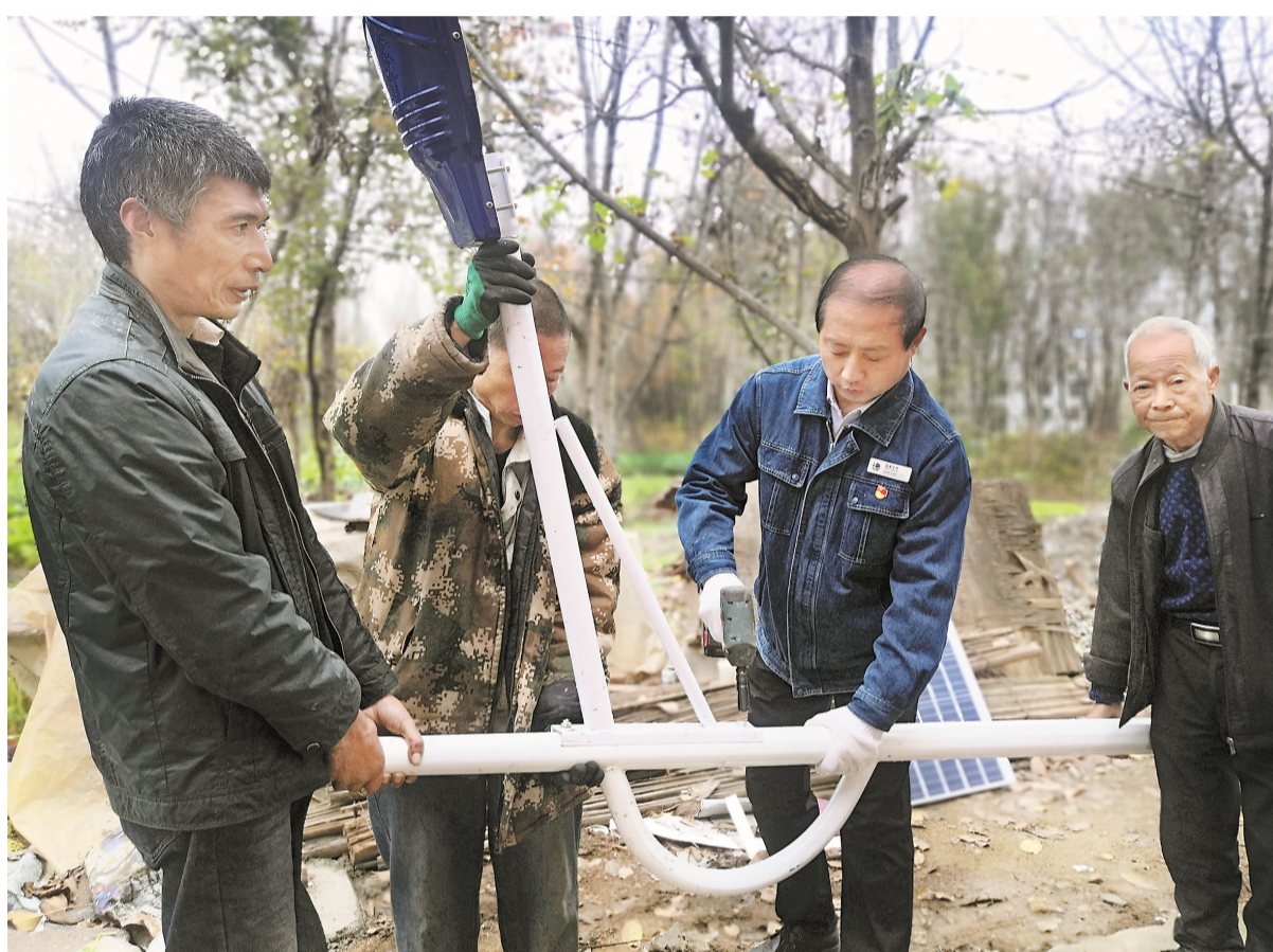
近日,国网商州供电公司组织职工为帮扶村杨峪河镇谢塘社区安装路灯。据悉,该公司争取了国网陕西省电力公司2022年度“国网赋能乡村工程”定点帮扶捐赠项目,为谢塘社区安装路灯61盏,硬化修建部分通村水泥路、文化广场,有力地推动了谢塘社区清洁用能,进一步完善了公共基础设施。(本报记者 肖云摄)
