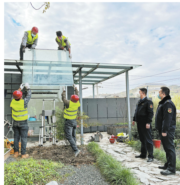
11月16日，商州区城管局综合执法大队在泰宇时代天地小区开展住宅小区及商铺楼顶露台违法建（构）筑物拆除整治活动，20名执法人员及10名工人对小区住户违法搭建的玻璃房、木亭子等进行依法拆除。（本报记者 方方 摄）
