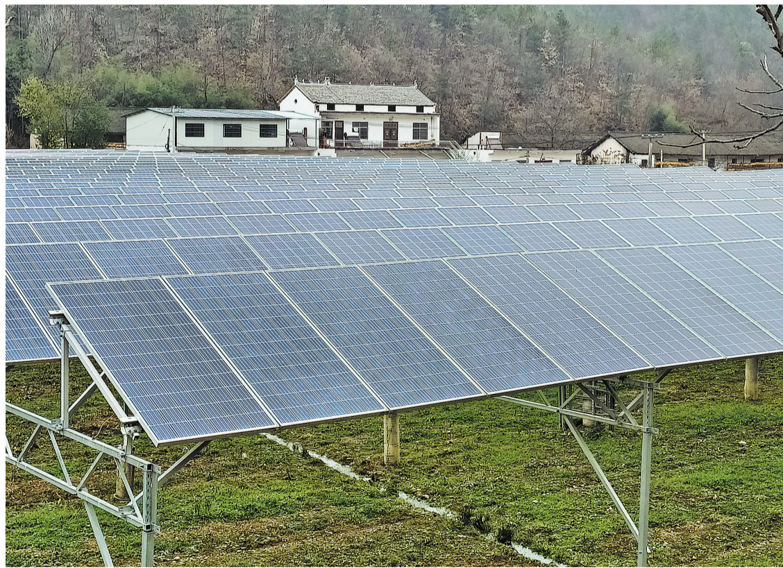
丹凤县苏陕协作扶贫项目——庾岭镇窑沟光伏发电总装机370千瓦,年发电40.7万度,可为窑沟村、石门堰村、塔儿坪村59户脱贫户每年户均增加收入2000多元,助力乡村振兴。(本报记者 贾书章 摄)
