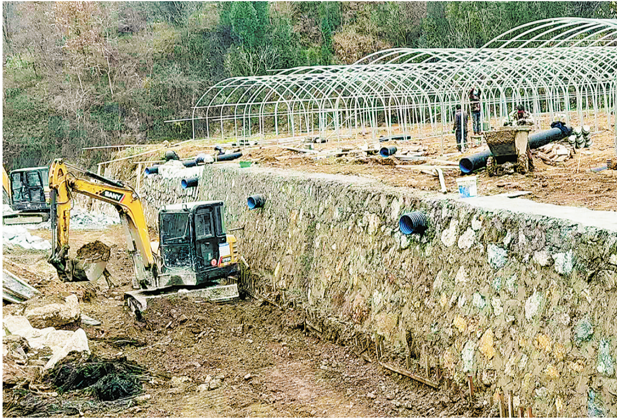
11月21日,工人正在商州区大赵峪街道办事处刘河村果蔬和药材工地施工。该项目预计建大棚13个,占地面积6000平方米,可解决30多弱劳动力就近就业,预计年收入达100万元以上。(本报记者 南玺 摄)
