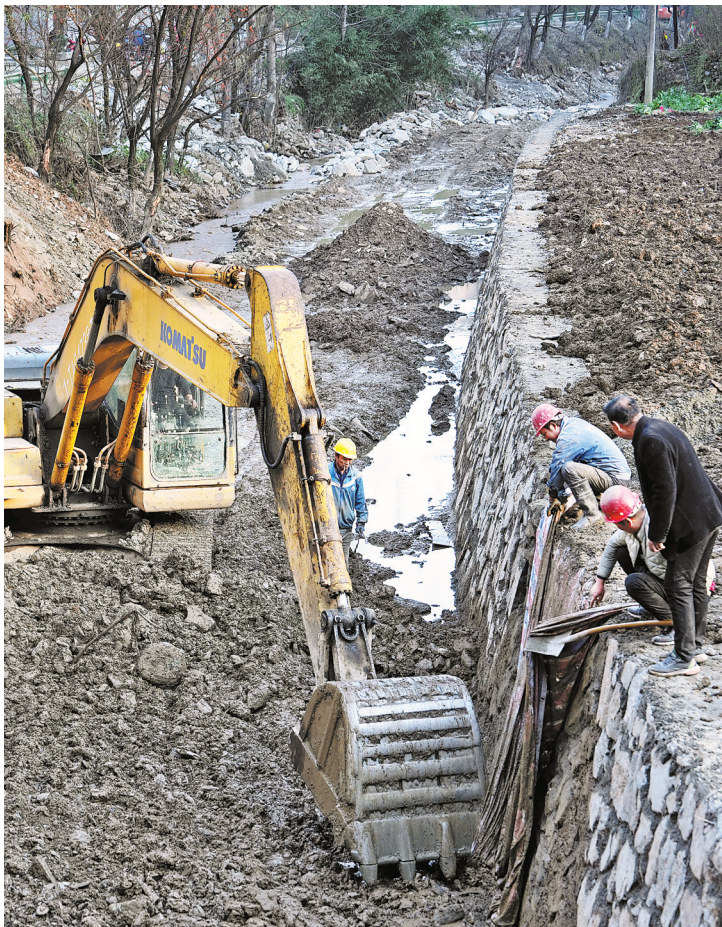
近日，商州区三岔河镇引龙寺村利用冬闲时节组织村民修复河堤。工程完工后，河道行洪更加通畅，路堤抗洪抗灾能力将进一步提升。（记者 李亮 摄）
