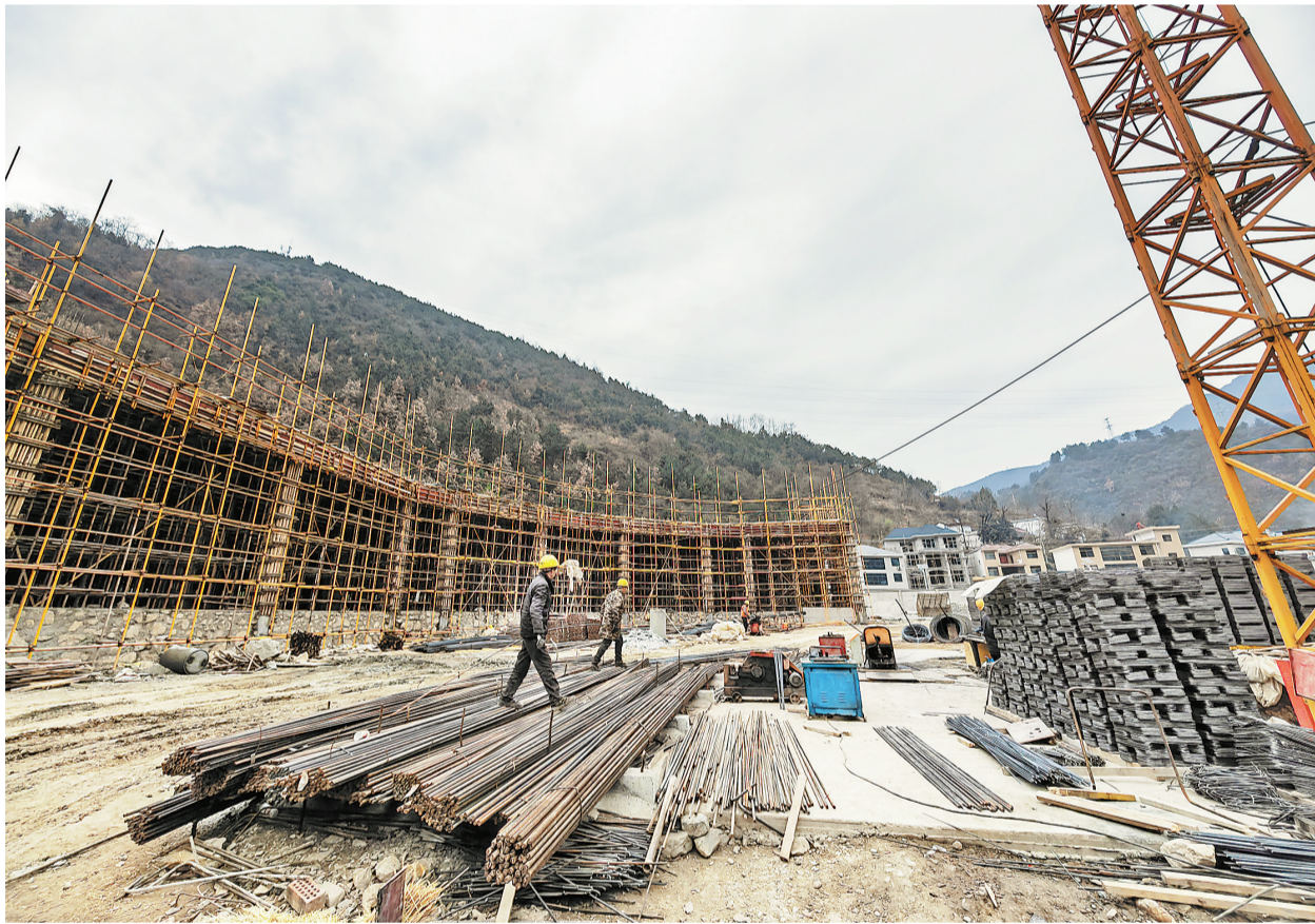
镇安县创盛农副产品深加工及冷链物流项目总占地19.49亩，总投资2亿元，预计2023年下半年投产。项目规划建设年屠宰15万头生猪先进生产线两条，全自动智能高低温冷库一栋共三层，建筑面积约7000平方米，储藏量1.5万立方米。项目建成后将为镇安及周边县区居民提供肉食品、农副产品、冷链储备等服务，让居民就近享受低价优质的放心肉食品及农副产品。 (本报记者 李亮 摄)
