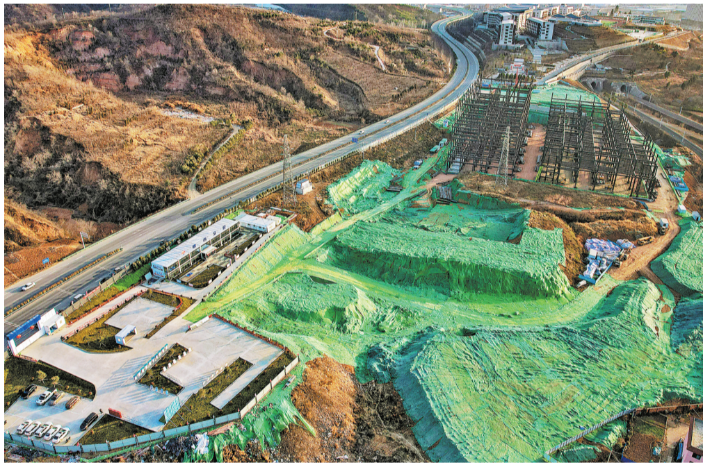
市交通综合物流园项目位于商州区中心城区最东端，该项目总占地面积一百三十多亩，总建筑面积约二十三万平方米，计划二〇二五年建成投用。项目建成后，将弥补我市冷链仓储功能板块的缺失。图为二月十二日，市交通综合物流园项目施工现场。（本报记者 杨鑫 摄）
