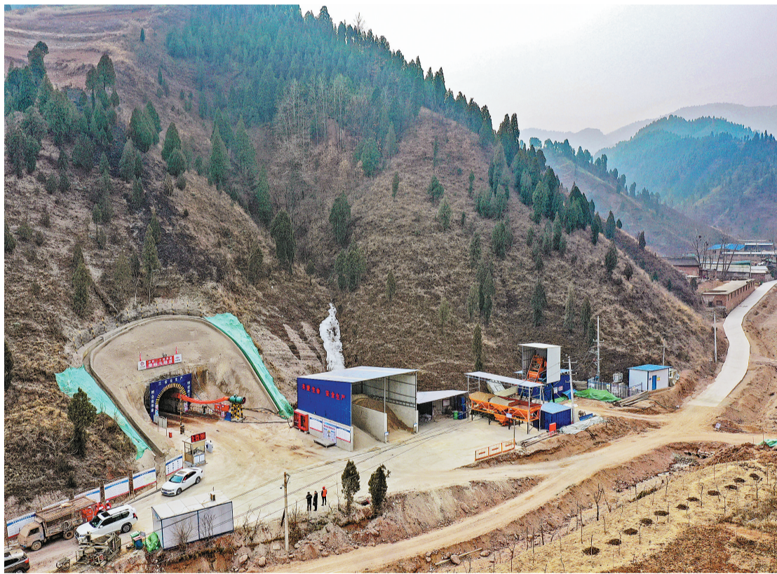
由国家管网集团承建的西气东输三线工程，陕西段管线途经商洛、渭南、西安、咸阳五市十四个县区。连日来，建设施工单位全力保障工程建设进度稳步推进。这是记者二月七日拍摄的位于商洛区的西气东输三线工程陕西段管沟隧道施工现场。（新华社记者 张博文 摄）
