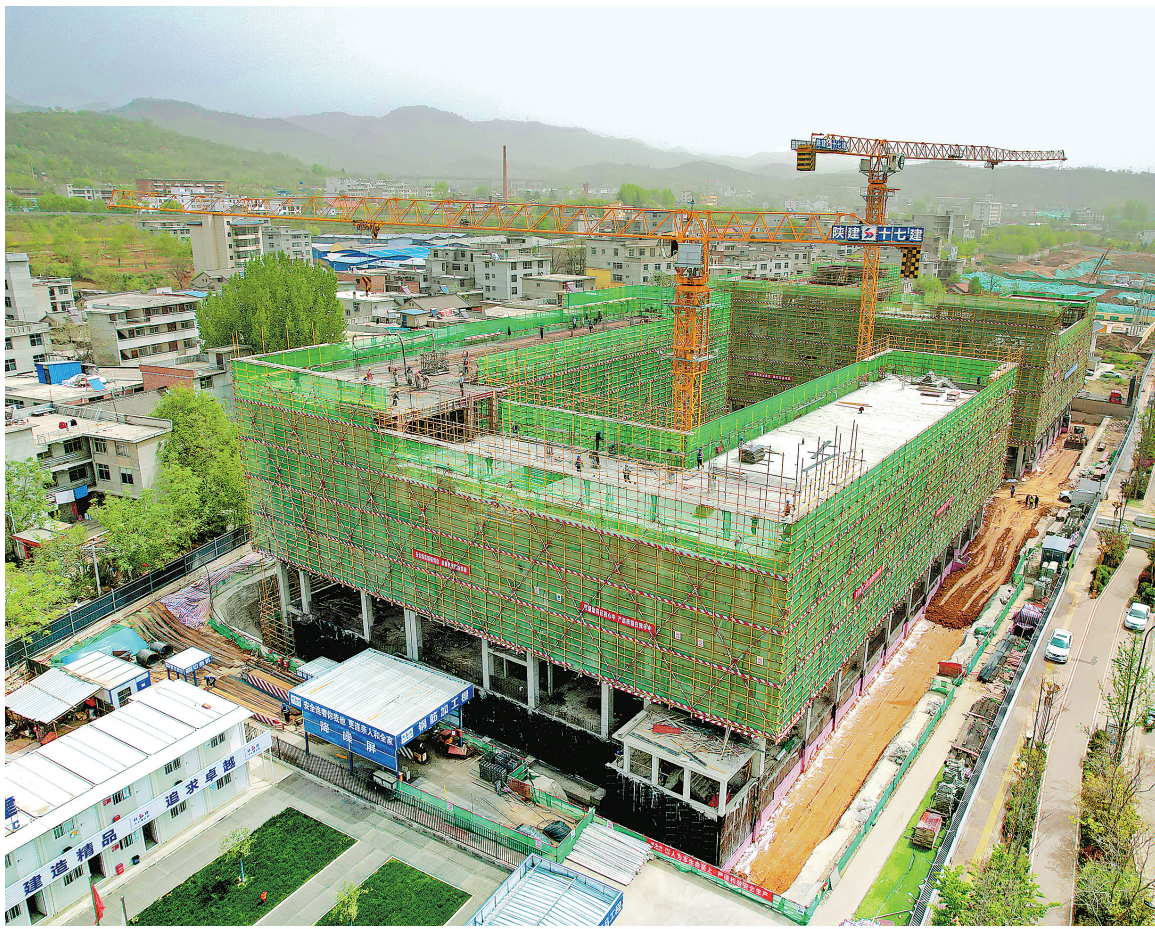
商州区第十五小学和第十三幼儿园建设项目，位于商州区大赵峪街道刘源社区，总建设面积62310平方米。据了解，该项目将在今年9月建成使用，届时可容纳1920名小学生及540名幼儿就学、入园。（本报记者 杨鑫 摄）
