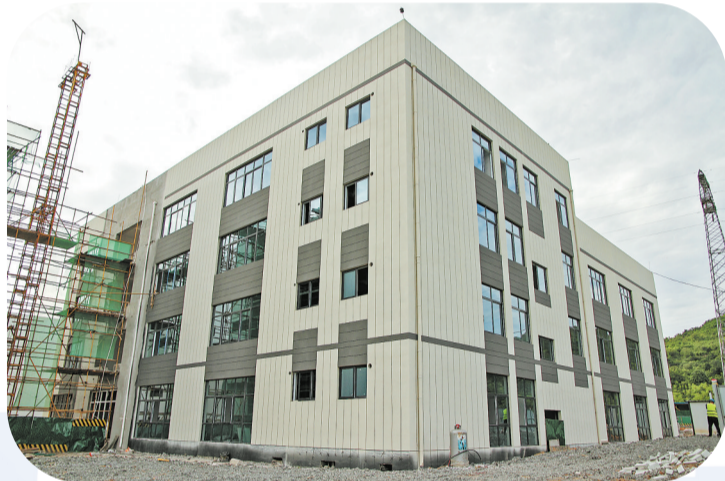
北坪现代工业产业园区标准化厂房综合楼正在内部装修
