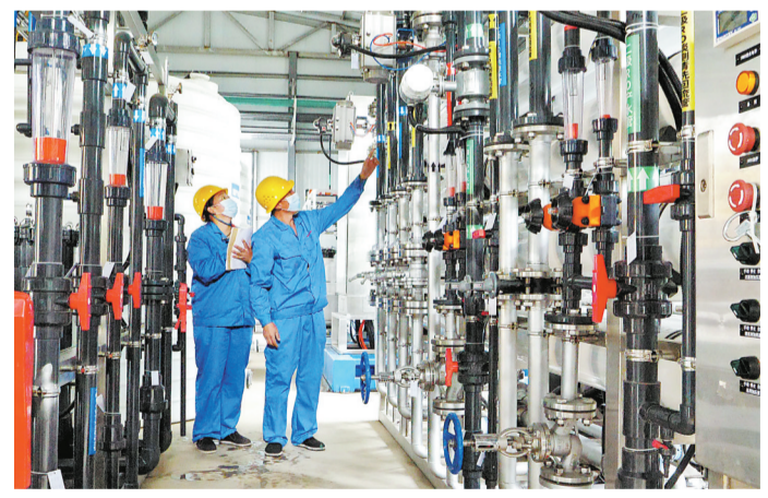
在洛南县华钼集团西部鑫兴钼产业园一期项目生产车间内,工作人员正在调试设备。
