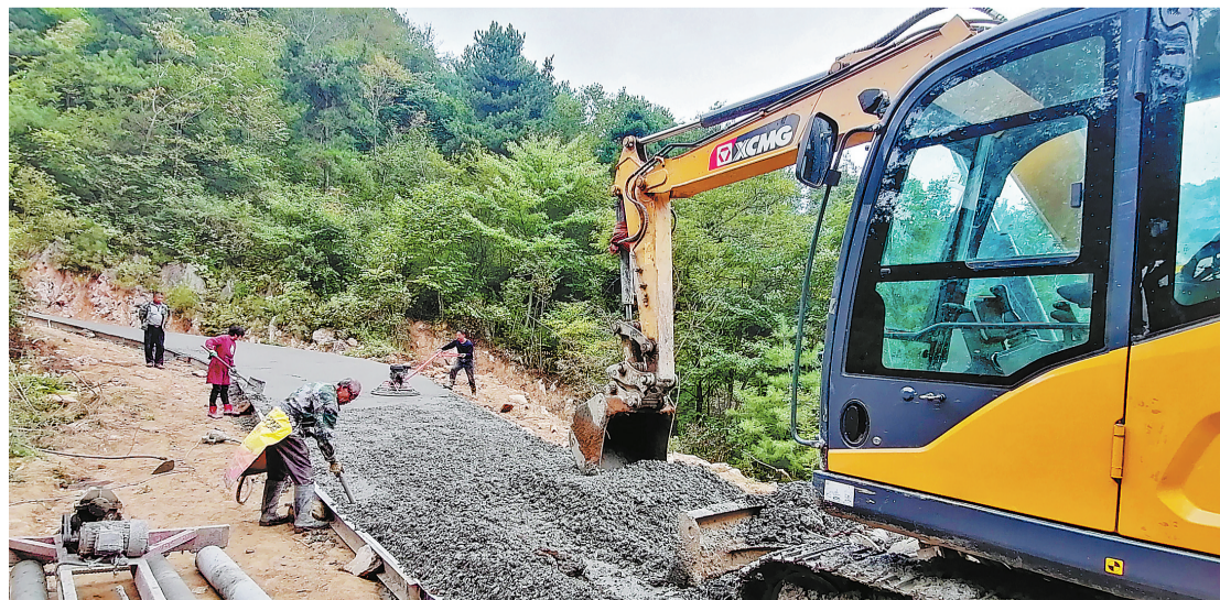
镇安县青铜关镇阳山村人口居住分散,境内山大沟深交通不便。近期实施的阳山村通组路拓宽硬化项目全长3.2公里,完成后可改善100多人的出行条件,同时为当地的华山松和中药材运输提供了便利。
