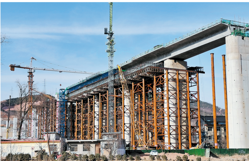
西十高铁南秦河特大桥经过建设者一年多的艰苦奋战，目前30多座桥墩已经建成，进入桥梁架设阶段。图为11月28日施工人员正在浇筑桥墩上的箱梁。（本报记者 刘桃李 摄）
