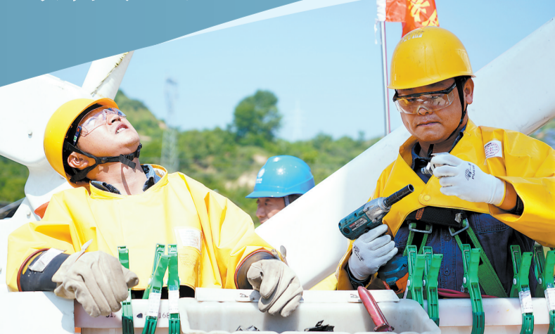
国网商洛供电公司工作人员开展配网不停电带电作业,消除线路缺陷隐患,加强设备运维,提升电网应急处置能力。
