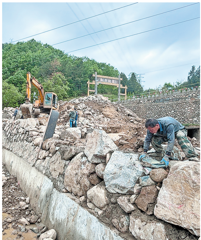
近日,商南县清油河镇抢抓时间,平整河床,加固修复河堤。图为洞场村河堤建设施工现场。(本报通讯员 胡朝斌 摄)
