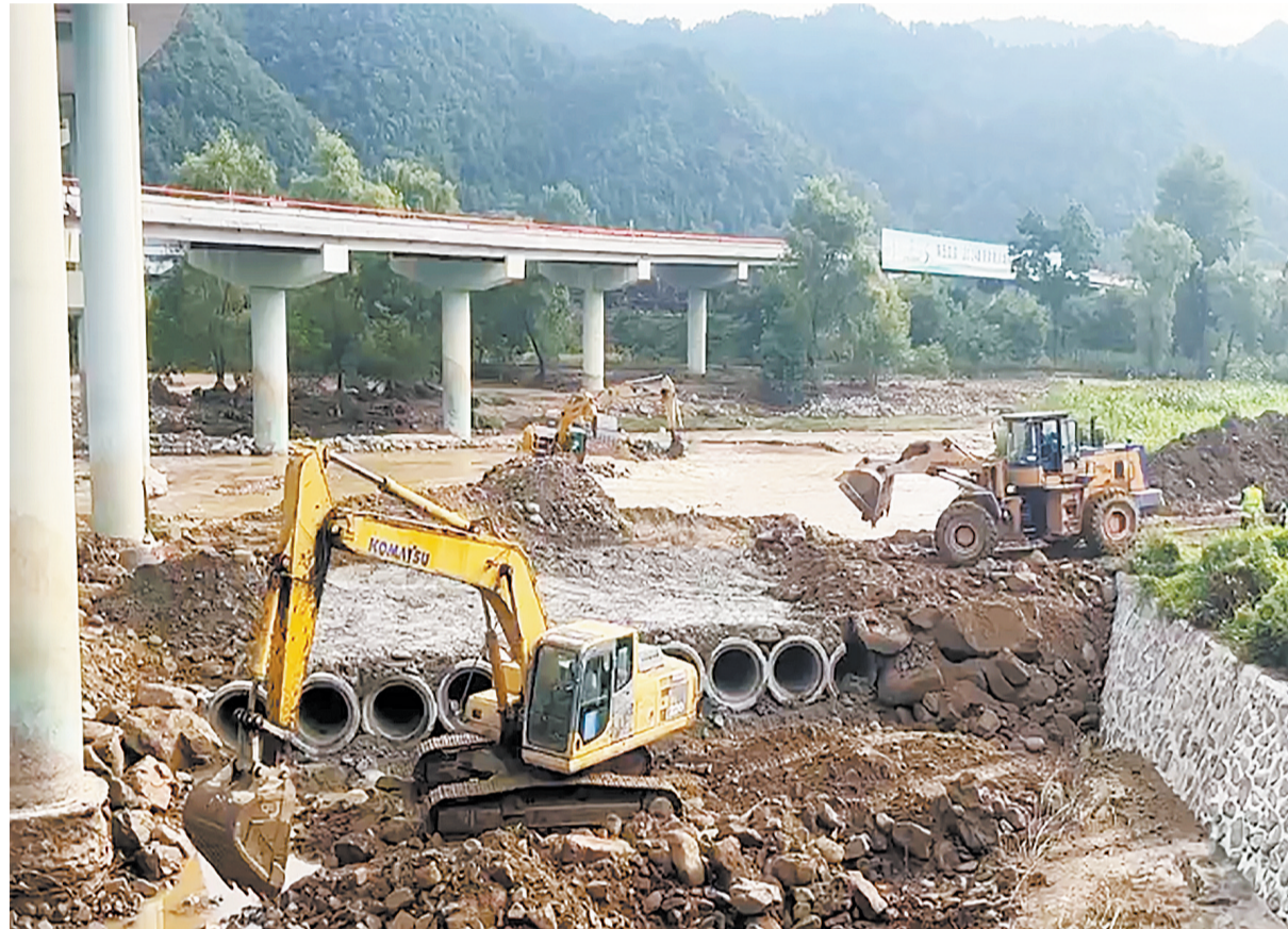
受近期强降雨影响,S313商州麻池河赤水塔塔桥桥台垮塌。7月21日上午,商洛市公路局工程队调集重型设备18台,投入人力40多人,连续昼夜施工32小时,于22日下午抢通道路,沿线村民恢复通行。(本报通讯员 陈丽霞 摄)
