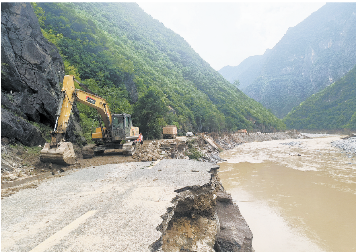
受近期持续降雨和多次短时强降雨影响,242国道山阳色河至宽坪段公路多处受损,部分路段交通中断。灾情发生后,市公路局拌合厂成立防汛抢险突击队,投入人员30多人、抢险机械11台,日夜奋战,以最快速度清理塌方、抢修便道,确保区域内普通公路的安全通行。(本报通讯员 杜妍 摄)
