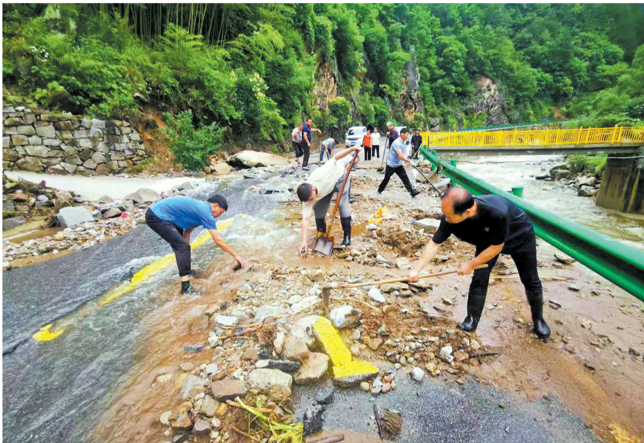
连日来的降雨导致镇安县木王镇栗扎坪村多处道路塌方,泥石流灾害频发。面对灾情,村干部立即行动,迅速组织党员群众60多人,成立3支防汛抢险志愿者队伍,开展防汛排查救灾工作,图为干部群众正在清理道路。(本报见习记者 孙远飞 摄)
