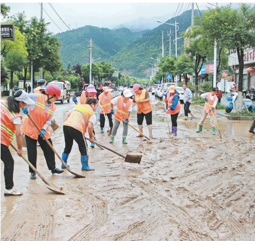
7月30日凌晨，丹凤县迎来一轮强降雨天气，导致龙驹寨街道下湾社区寨子沟大量淤泥涌上路面，对城市环境卫生及市民出行造成一定影响。丹凤县城市管理系统闻“汛”而动，采取人机结合方式，全力清理路面积水和淤泥，确保雨后路畅人安。(本报通讯员 刘振兴 摄)
